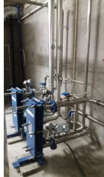
Ilustração 8: Permutadores de placas
